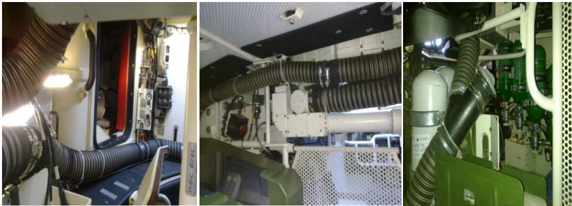
Integración del Sistema de AA. Partiendo de su instalación en la parte posterior de la torre, unos conductos hacían llegar el aire a la cámara de combate.
