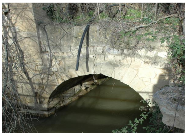
Imagen 58. Conjunto hidráulico de Alforque, Fuente: SIPCA.
