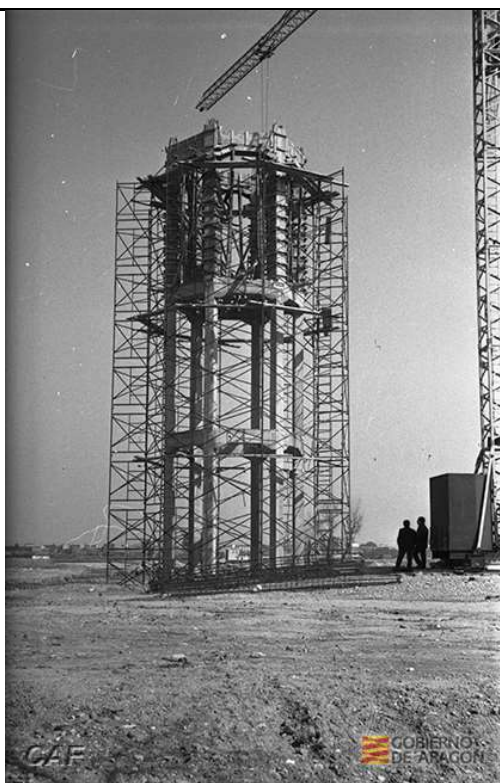
Autor Construcciones y Auxiliar de Ferrocarriles (CAF) Título Construcción depósito agua nueva factoría Cronología ca. 1967 Soporte Blanco y negro. 35 mm. Negativo
