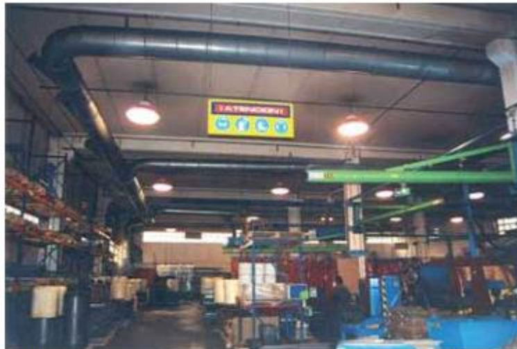
Sistema de ventilación mecánica en una nave de soldadura.
