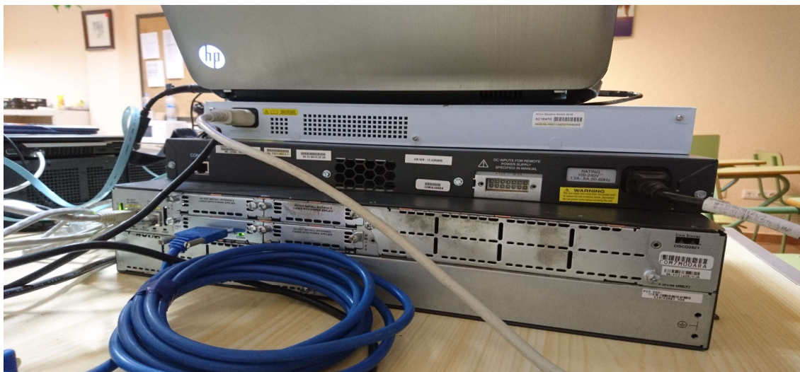
Figura Anexo F - 3: Detalle de las conexiones Ethernet y serial WIC del router R1
