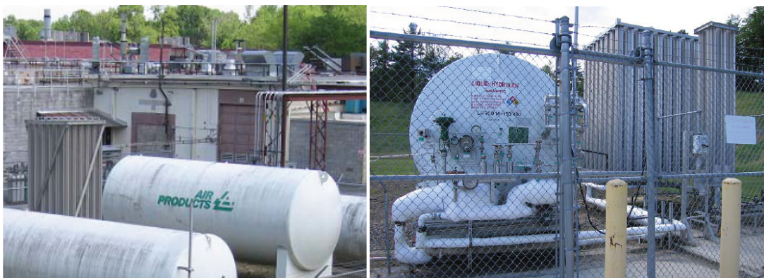
Figura 33. Tanques criogénicos para el almacenamiento de hidrógeno licuado a -253°C
