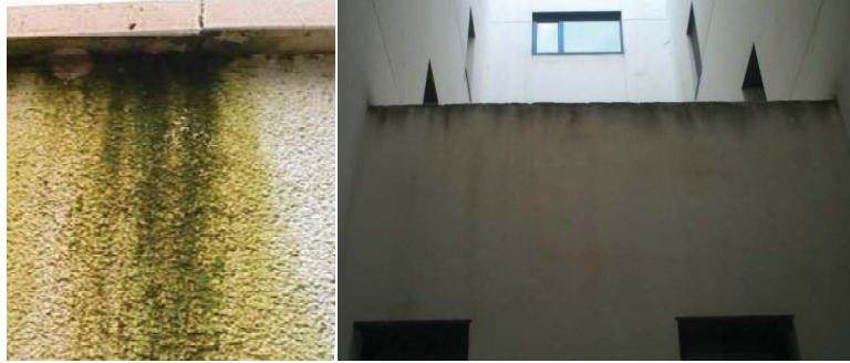
Figura II.11.- Lavado diferencial o “churretones” en fachada, como consecuencia del escurrimiento a baja velocidad de agua y carencia de goterón, desde una terraza superior.
