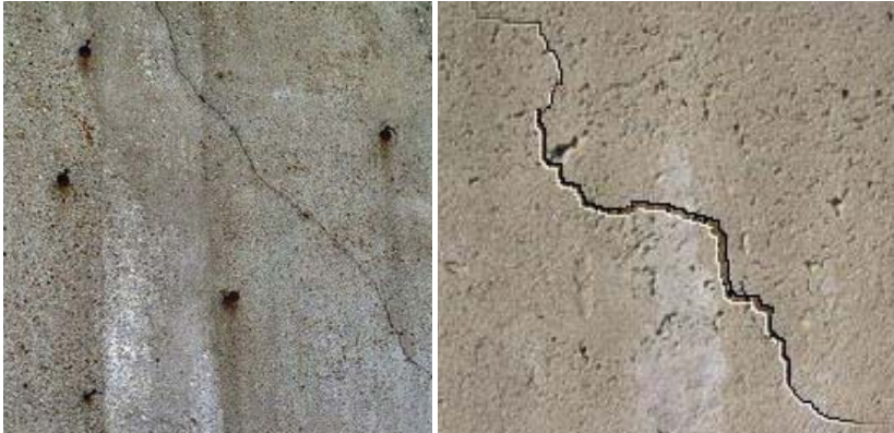
Figura II.18.- Fisuraciones y grietas de mayores dimensiones en muros de hormigón.
