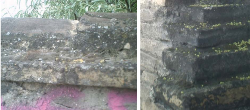
Figura II.25.- Detalle de eflorescencias y procesos bioquímicos sobre albardilla cerámica en muro a la intemperie.
