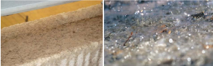
Figura II.10.- Estado de saturación en la superficie rugosa de un antepecho, provocado por lluvia intensa e impacto de agua de lluvia sobre superficie saturada.
