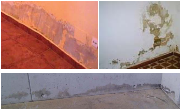
Figura II.4.- Manchas y desprendimientos de revestimientos ocasionados por la ascensión capilar de humedad contenida en el terreno a través de los materiales de la envolvente.
