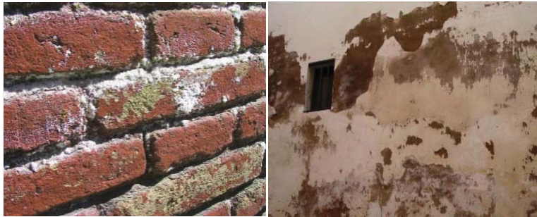
Figura II.23.- Aparición de eflorescencias en ladrillos. Es en las partes más expuestas de las obras de fábrica donde primero afloran las sales solubles: Broto, 2005.
