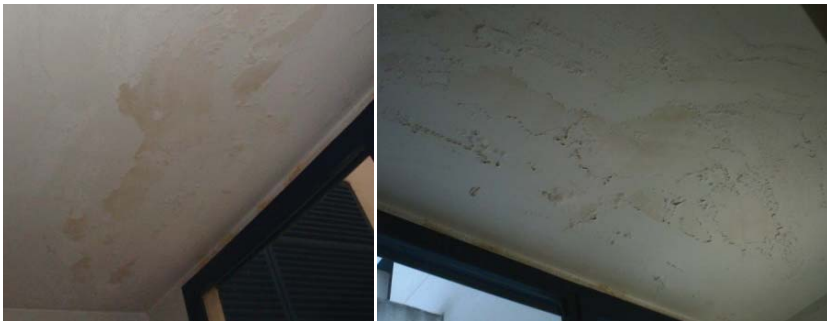
Figura II.3.- Afección patológica en enlucido de yeso pintado en falso techo, como consecuencia de la rotura de una conducción de evacuación de aguas.
