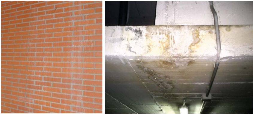
Figura II.26.- Eflorescencias derivadas del escurrimiento de agua fecal sobre fachada de ladrillo caravista y derivada de aguas cloradas en el forjado de soporte para una piscina.
