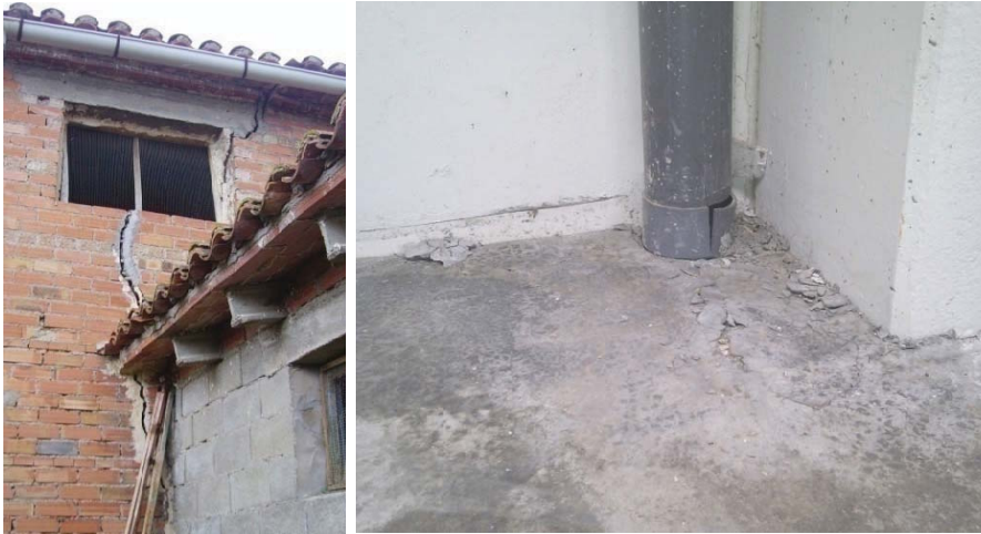
Figura II.16.- Graves síndromes en la fachada de un edificio por asentamiento diferencial de la cimentación (izq.) y hundimiento de solera y conducciones de evacuación por el asentamiento de pilar, derivado de la rotura de una conducción de abastecimiento enterrada cercana (der.).
