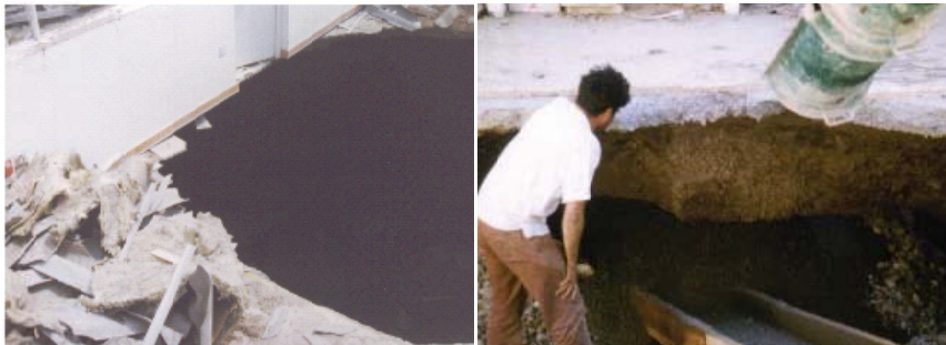
Figura II.17.- Oquedad desarrollada bajo cimentación de planta industrial en suelo kárstico del valle del Ebro. Detalle de cimentación carente de apoyo.
