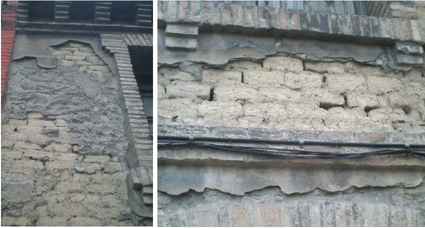
Figura II.20.- Desprendimiento de revestimiento continuo exterior y conservación del mismo en áreas bajo aleros y vierteaguas, por menor incidencia de la climatología atmosférica.
