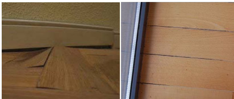
Figura II.13.- Deformaciones típicas en parquet en contacto con la humedad, como consecuencia de la deformación por incremento de volumen.
