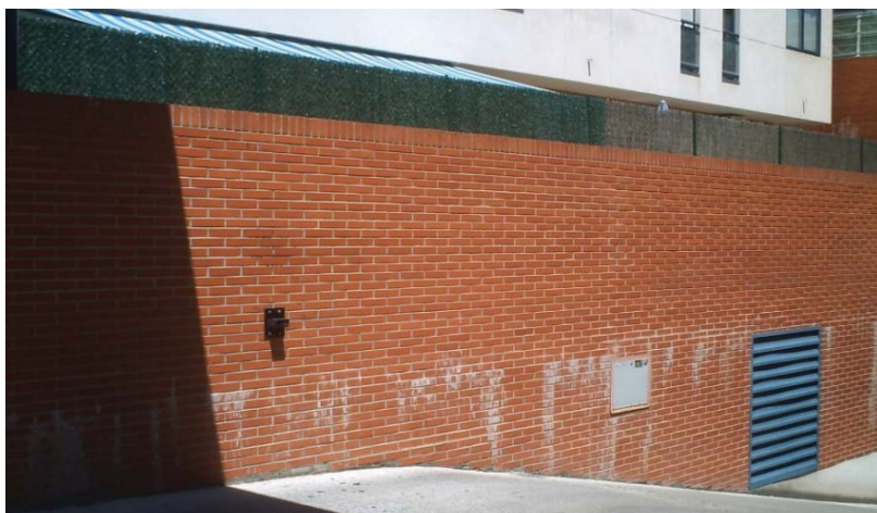
Figura II.24.- El riego frecuente de la terraza posterior, arrastra las sales disueltas en el mortero de la fábrica, provocando eflorescencias a la altura del suelo en el muro de rampa de garaje.
