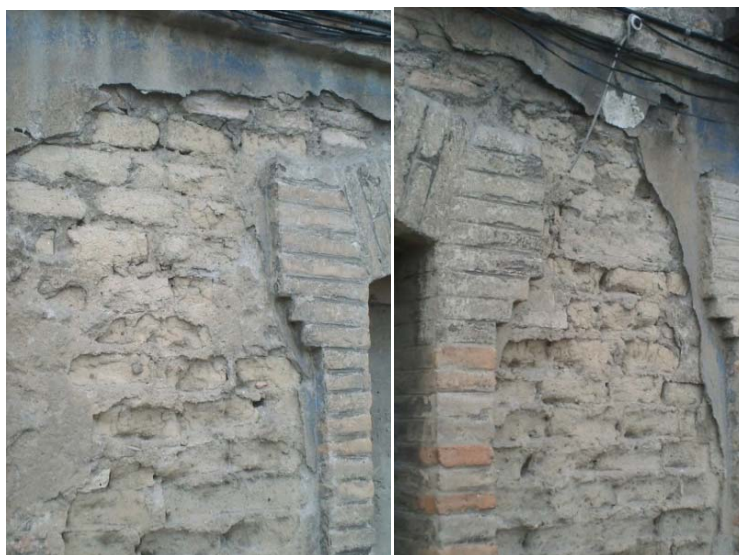
Figura II.9.- Desprendimiento de revestimiento continuo exterior y erosión de fábrica de adobe como consecuencia de la acción continuada de humedad por precipitaciones atmosféricas.
