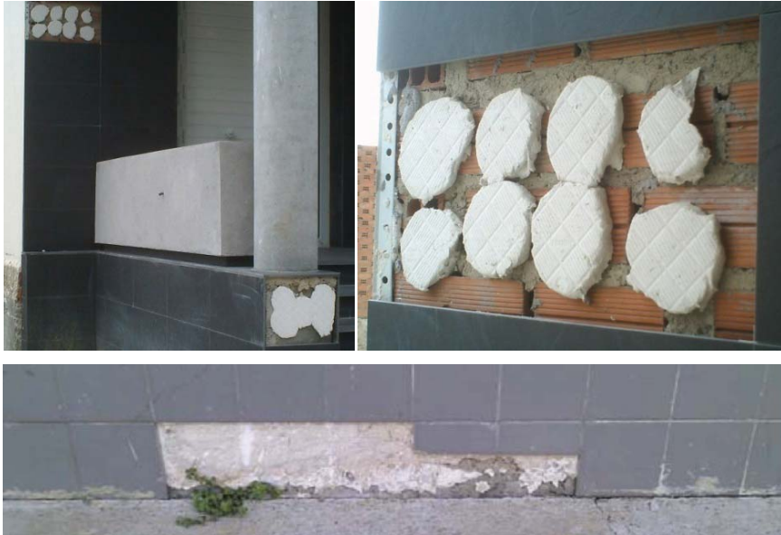
Figura II.19.- Desprendimiento de aplacado sobre soporte de fábrica en fachada y muro de hormigón. Deficiente adherencia en la interfaz entre mortero y revestimiento, a consecuencia del secado excesivo derivado de su ejecución en verano.
