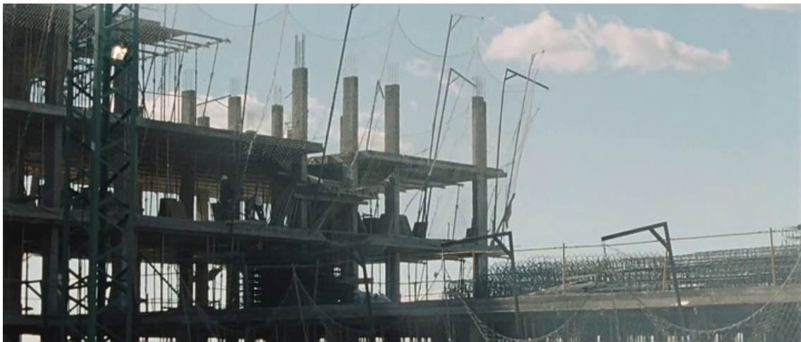
Fig. 18. Plano general que muestra la importancia del tema de la construcción y que se relaciona con el trabajo de Carlos y Raúl. El colofón a la burbuja inmobiliaria queda atrapado en este espacio arquitectónico vacío, desvencijado, a medio construir-destruir. Rosales dota a los espacios vacíos de una fuerza silenciosa que incide directamente en la época retratada y en las consecuencias que acarrea la toma de decisiones ambiciosas.
