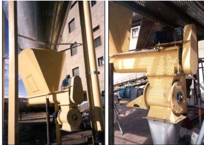
Figura 3.16. Detalle del sistema de descarga del silo.
