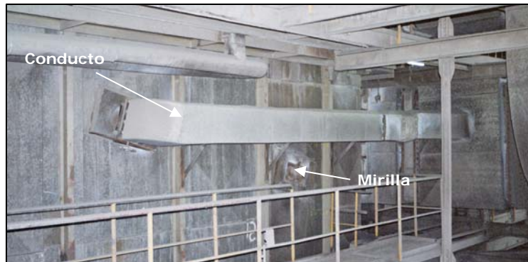
Figura III.3. Detalle de la pared lateral de caldera en la que instalar los quemadores
