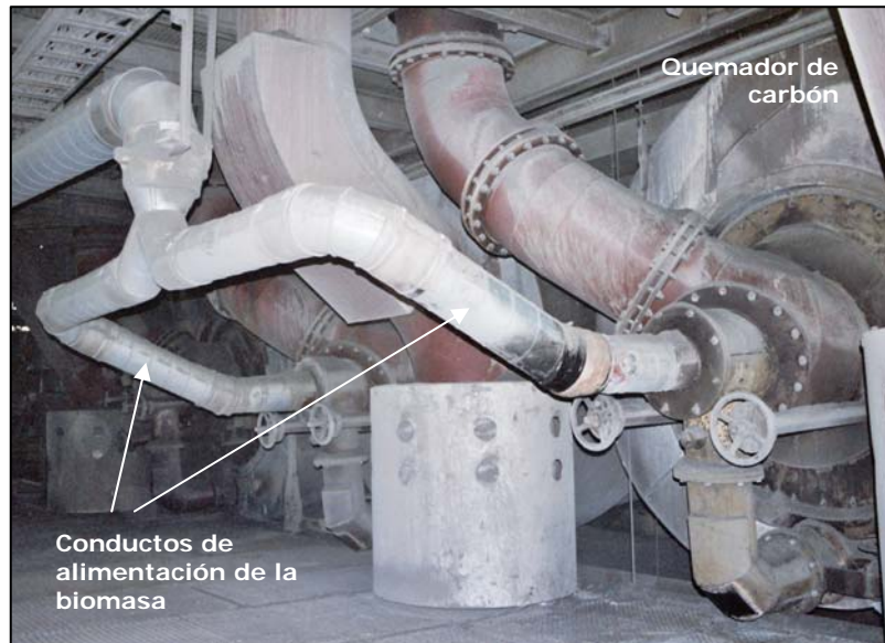
Figura 3.11. Conductos de alimentación de la biomasa.
