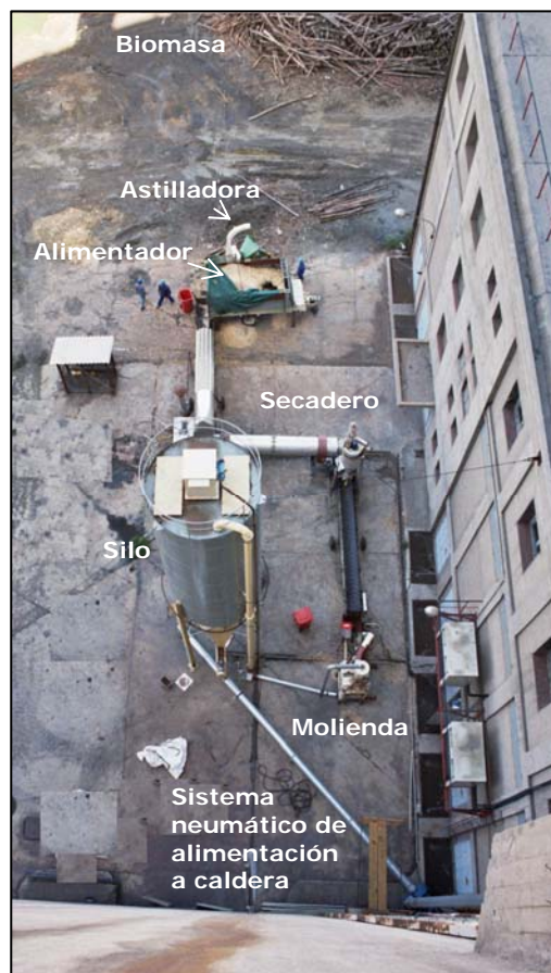
Figura II.5. Vista aérea de la instalación de pretratamiento y del sistema neumático.
