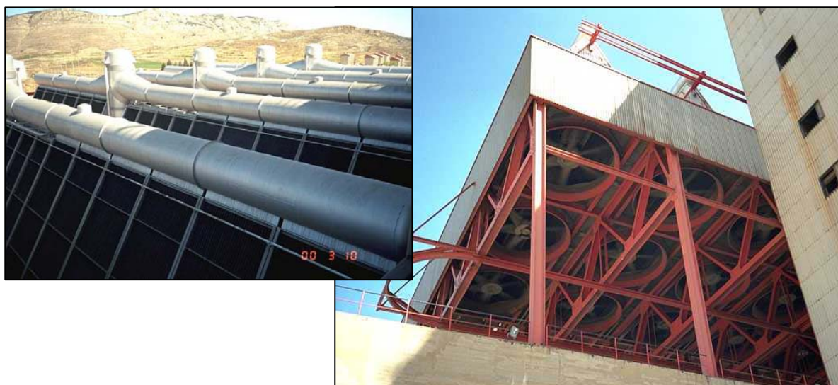
Figura 4.28. Imágenes del aerocondensador instalado en la C.T. de Escucha.
