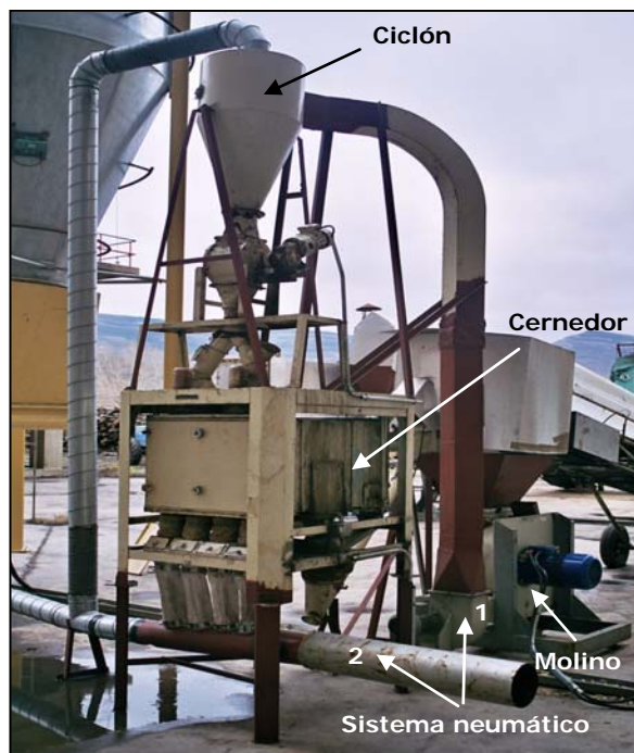
Figura II.4. Imagen del sistema de molienda instalado en la planta.
